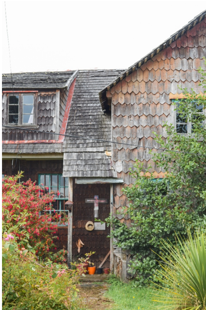
Figura 3: Casa en donde vivía Mariano Puga y la tejuela de alerce. Colo, Chiloé. Fotografía: Isidora Ayala C. (2020)
